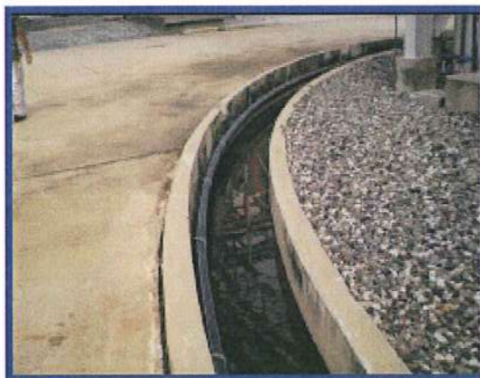
(จ) รางระบายน้ำฝน
