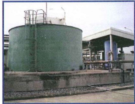
(ข) บ่อรวบรวมน้ำเสียจากกระบวนการผลิต
