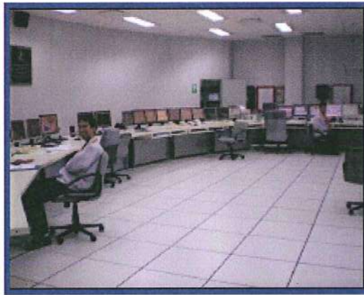
(ณ) ห้องควบคุมส่วนกลาง
