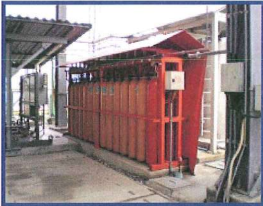
ถังดับเพลิงชนิดคาร์บอนไดออกไซด์อัตโนมัติ
