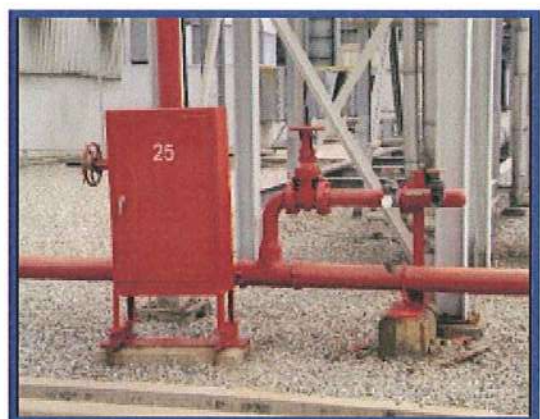
หัวฉีดน้ำดับเพลิง และตู้สายน้ำดับเพลิง
